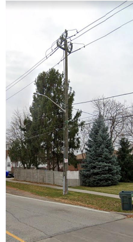
27.6kV, 600A Manual Switch
